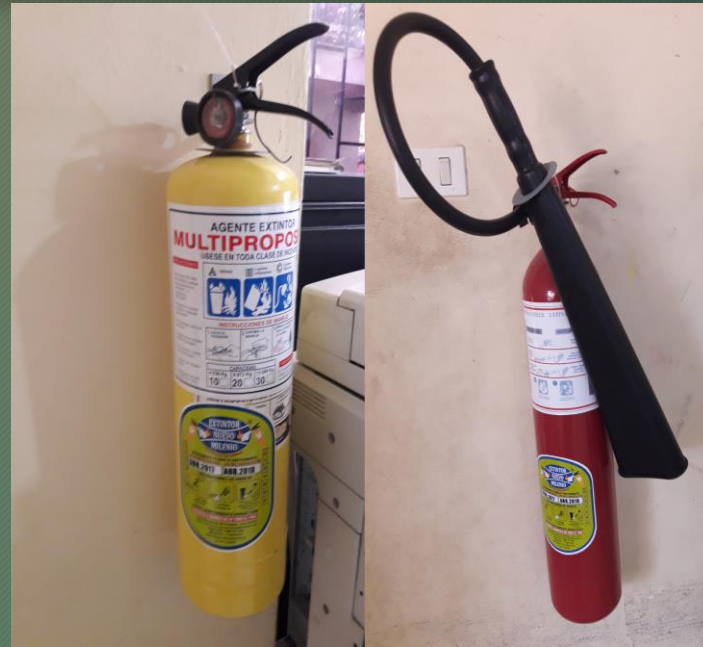
Dotación de extintores
